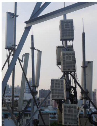
Station de base distribuée traditionnelle
